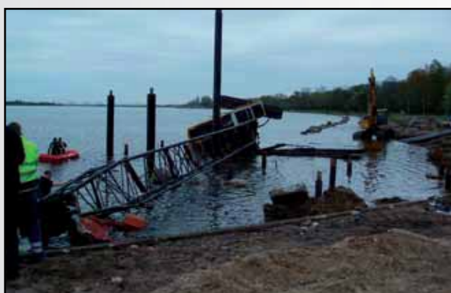
Pfahlramme im Binnensee umgestürzt
